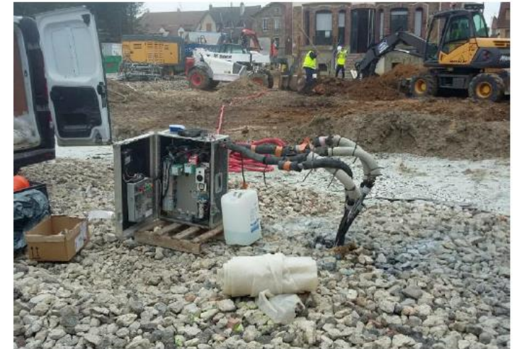
Module de test sur site
